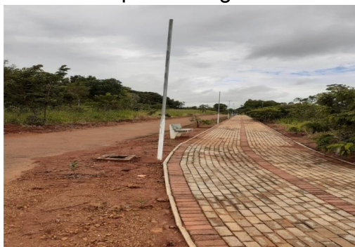
FIGURA 4: postes degradados faltando luminária.
