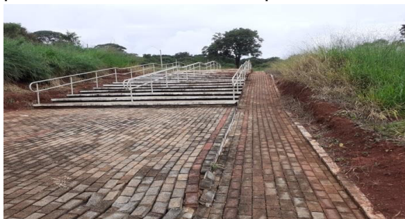
FIGURA 5: Escadaria abandonada com pintura mofada, blocos do piso soltos.
