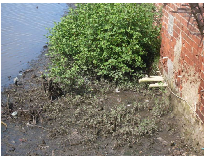
Figura 06 – Irregularidade no sistema de esgotamento sanitário nas margens do Rio Sanhauá (Bayeux, 2009)
