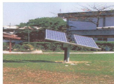
Figura 4.25. Sistema Fotovoltaico Móvel
